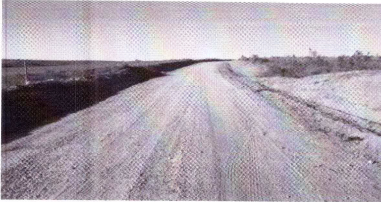
MATERIAL DE PIÇARRA ESPALHADO NO LEITO DA ESTRADA
